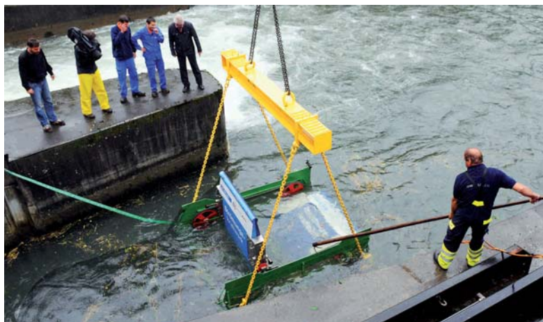
Strömungskraftwerk wird gewässert: Im Unterwasser des Kraftwerks Blatten der SAK in Oberriet erlebt das Projekt der TFC Engineering AG und der Kelag AG seine Wassertaufe. Das Schweizer Fernsehen filmte für «Einstein». Bild Heini Schwendener
